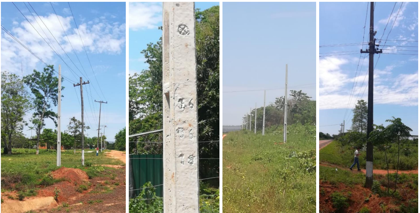
Construcción de Redes de MT, BT y Montaje de PD. Licitación Pública Nacional ANDE N° 1321/2017, Asent. Tava Guaraní, Distrito de Santa Rosa del Aguaray. Dpto. de San Pedro. Lote 2 – Bonos II
