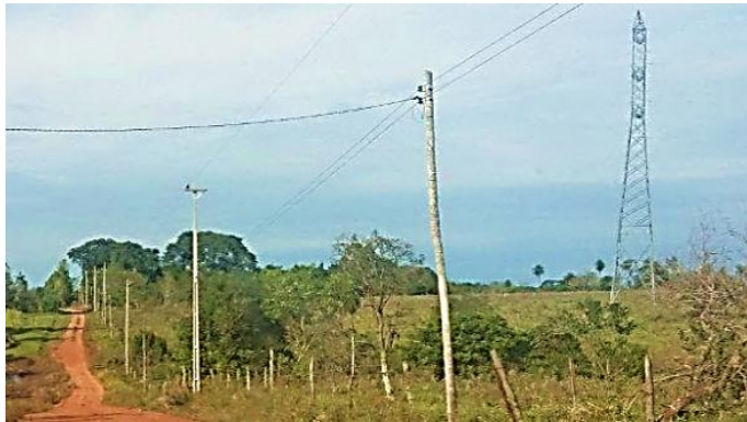
Ejecución de Trabajos de Normalización de Líneas de Autoayuda de BT y MT Licitación Pública Nacional ANDE N° 991/2014 - Lotes 3 y 6 - BONOS I
