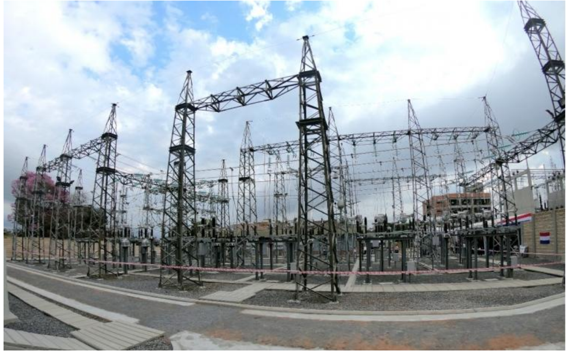
Ampliación de la Subestación LAMBARÉ Licitación Pública Internacional ANDE N° 914/2013 - Lote 5 - BONOS I
