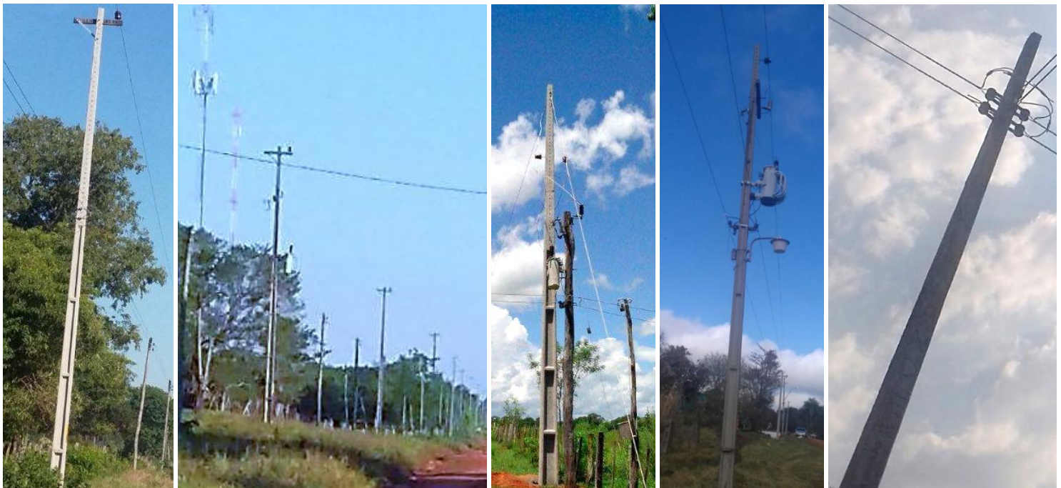
Ejecución de Trabajos de Normalización de Líneas de Autoayuda en MT y BT Licitación Pública Nacional ANDE N° 992/2014 - Lotes 1, 2, 3, 4 y 5 - BONOS I
