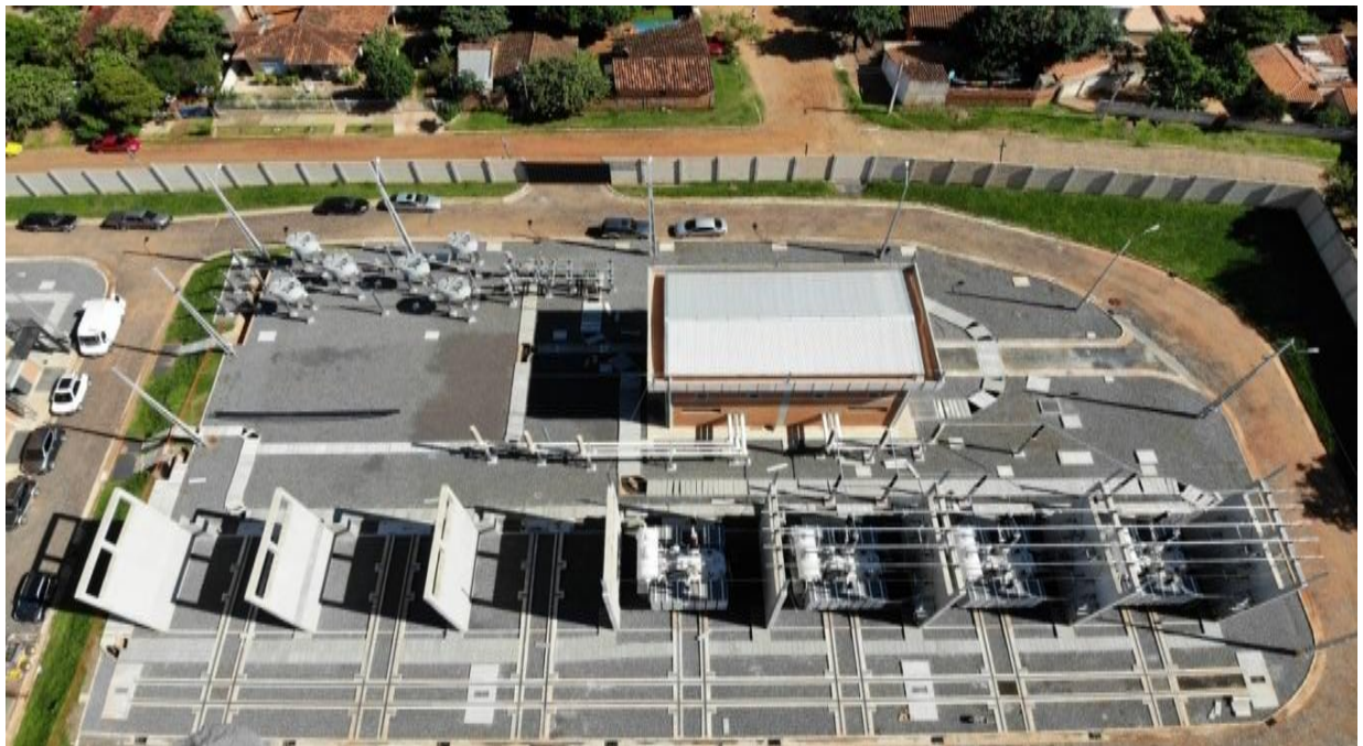
Construcción de la Subestación Barrio Molino en 220/66/23 - Licitación Pública Nacional ANDE N° 1090/2014 - Lote 1 - BONOS II
